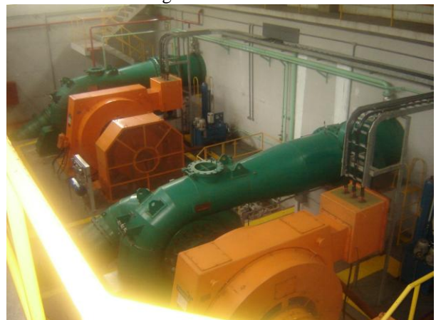
Figura 12. Unidades geradoras da UHE Mello: 2 x 5 MW.
